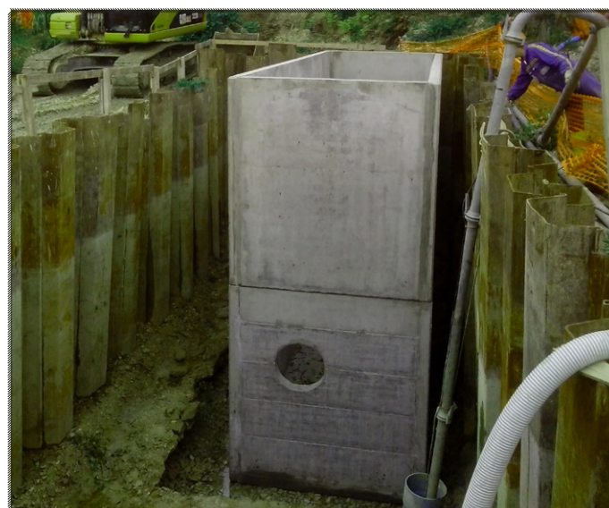
Vasche di manovra in CAV per acquedotto. Montecassiano (Macerata) / Committente Acquedotto del Nera
