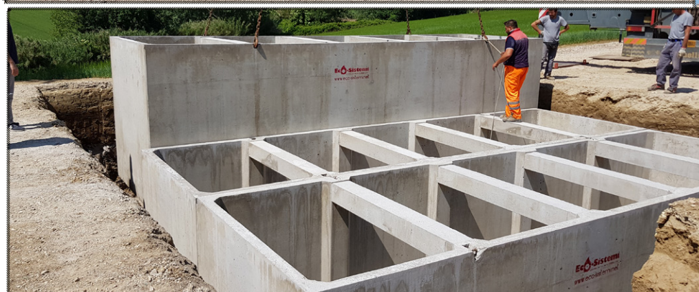
Vasche di sollevamento in CAV, complete di pompe e pozzetti di manovra, per sollevamenti fognari. Ascoli Piceno / Committente CIIP
